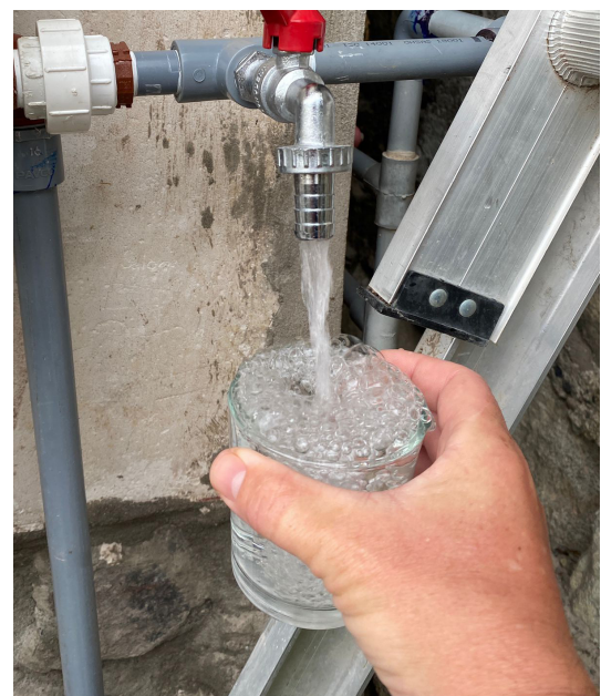
Después: agua potable cristalina y limpia tras la ultrafiltración de Seccua
